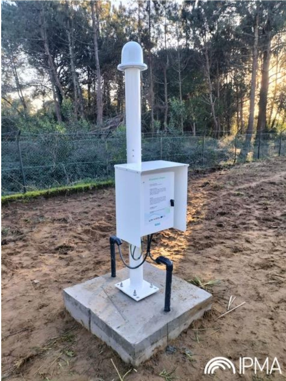
Figura 5: Detetor de raios - Viana do Castelo
