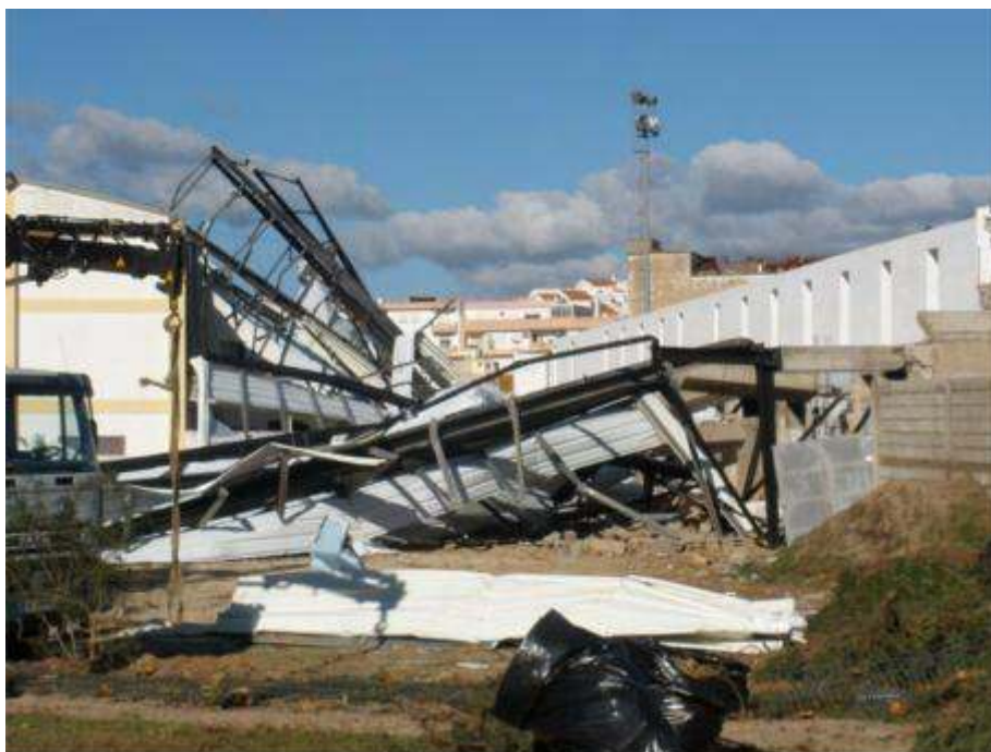
Figura 1 – Tornado de Silves - Destruição da estrutura de suporte da pala da bancada do estádio Dr Francisco Vieira (Silves). Fonte: Pinto P., Leitão P.
